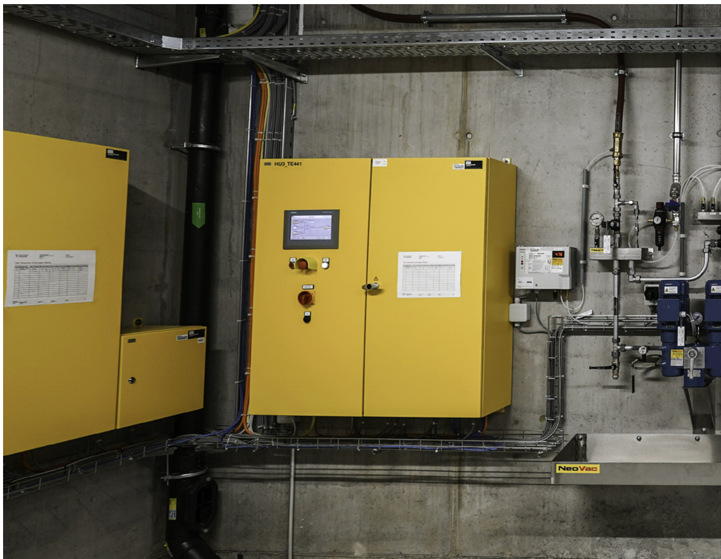
L'installation d'approvisionnement en combustible est conçue de manière redondante. Les deux systèmes fonctionnent de manière autonome. Si l'un tombe en panne, l'autre prend automatiquement le relais.
