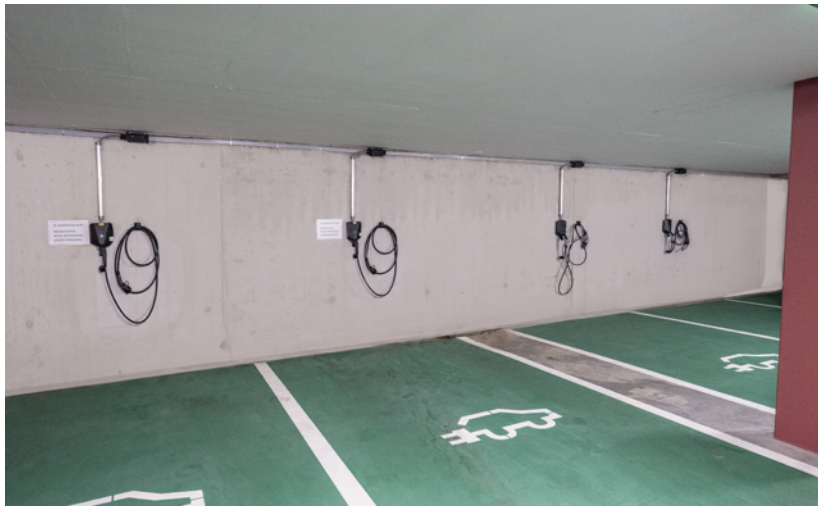
Si nécessaire, les bornes de recharge peuvent être étendues à volonté.
