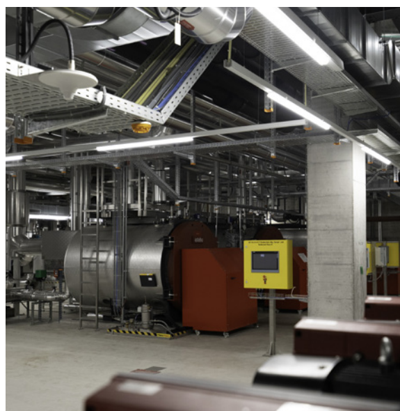
On voit ici les deux chaudières à vapeur et à l'arrière-plan, la chaudière de chauffage de secours.
